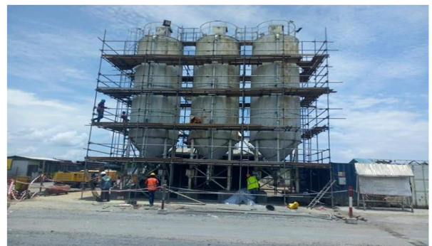
Centrale à Béton au projet de construction du deuxième pont sur le Wouri
